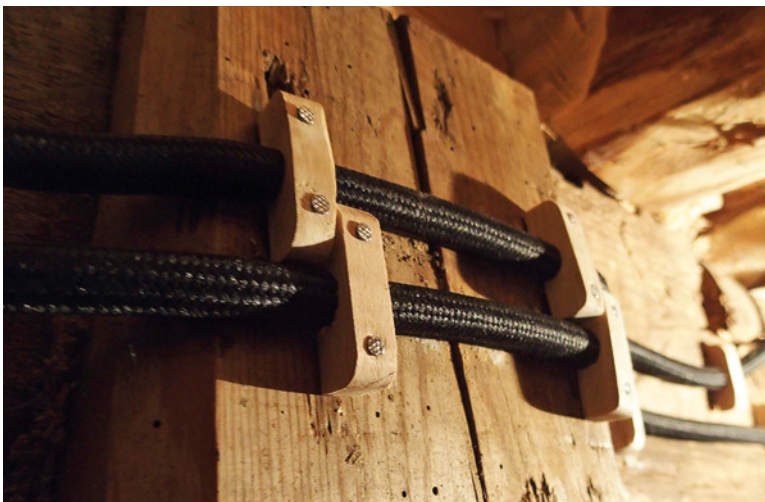
Przykład ciekawie ułożonej zewnętrznej instalacji elektrycznej w budynku drewnianym
