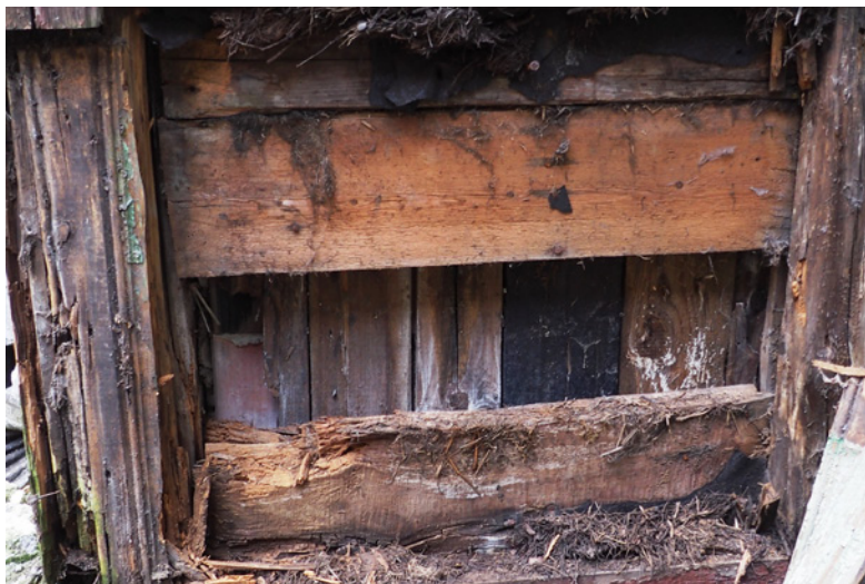
Przykład zniszczonej ściany sumikowo-łatkowej
