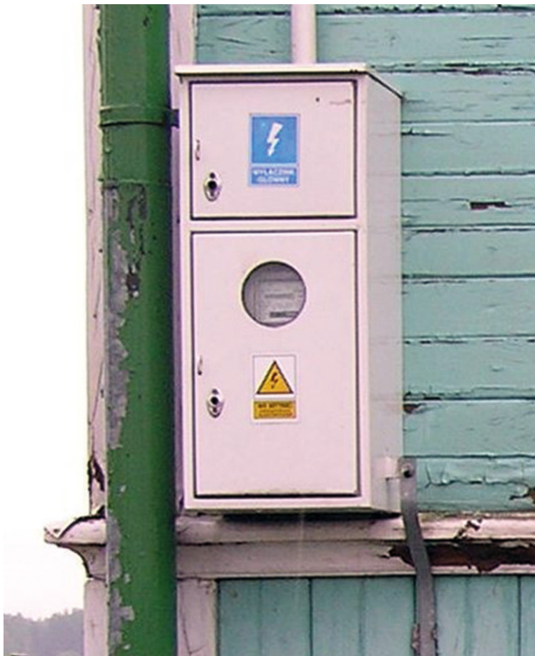
Przykład bardzo niebezpiecznego błędu. Zainstalowanie skrzynki elektrycznej przy rynnie
